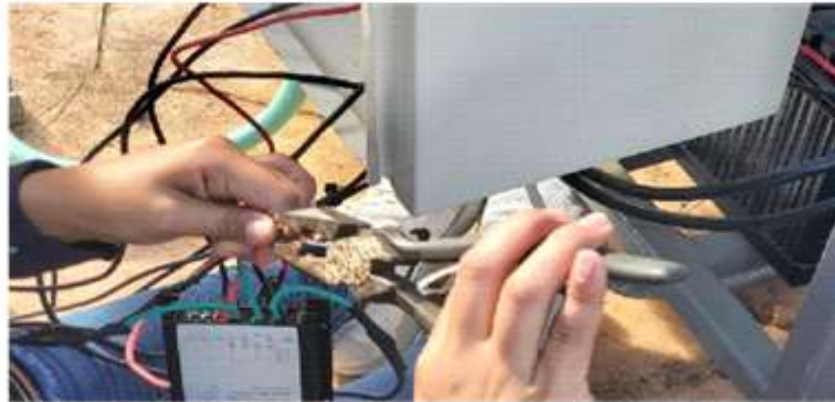
Ilustración 6. Conexión entre los cables salientes del aerogenerador y poste, con el banco de pilas
