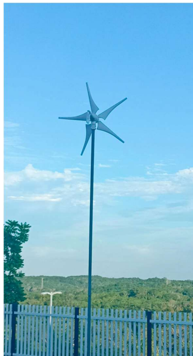
Figura 2. Aerogenerador instalado en la facultad de ingeniería UAC.
